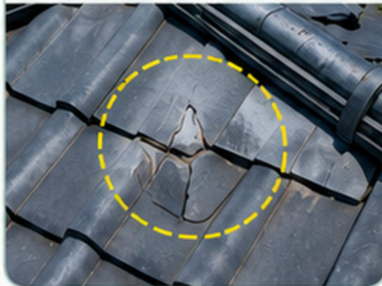
破損箇所のズーム画像
